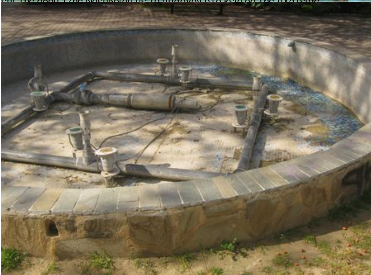
είναι ο κύριος θάλαμος όπου λειτουργούν όλα τα μηχανοκίνητα στοιχεία της εγκατάστασης, αισθητό ότι απλά δεν διαφέρει από η
